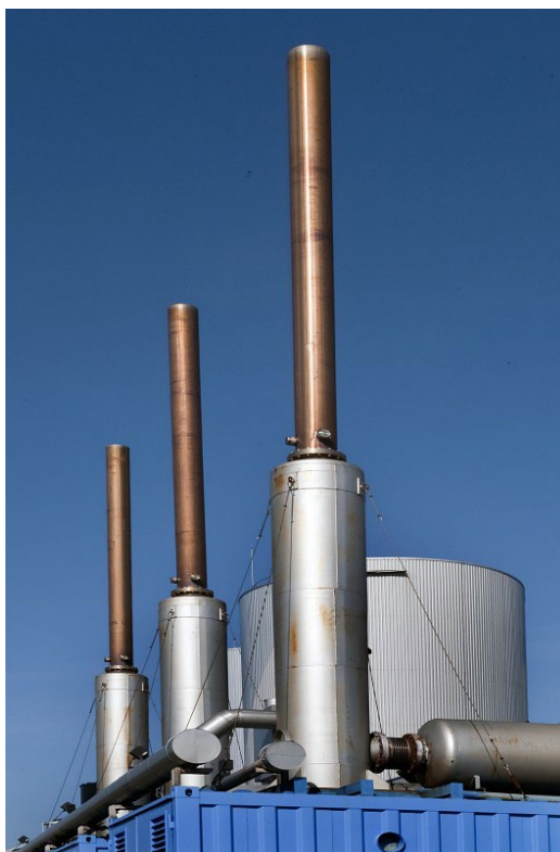
Groupes électrogènes - Usine de méthanisation de Varennes-Jarcy (91) | Crédits : Laurent Mignaux / Terra
